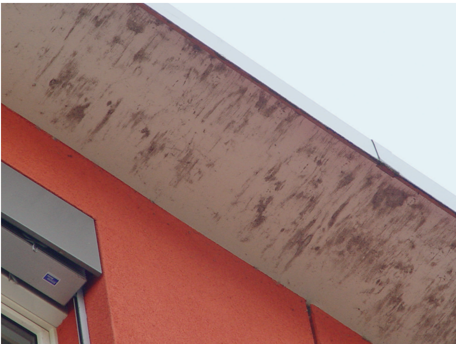
Pilzbefall an einem Neubau nach drei Jahren. Die Dachuntersicht wurde mit einem wässrigen Acrylsystem gestrichen. (Bild: Kabe)
