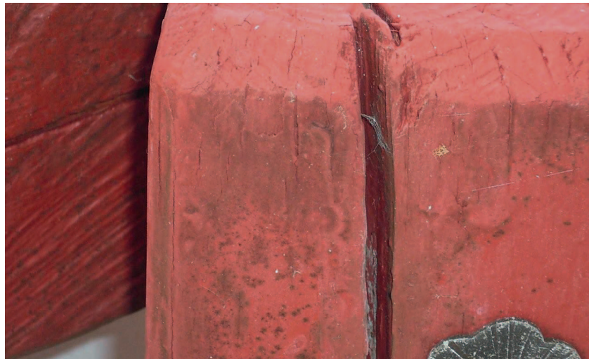
Roter Balken, Anstrich Holzdispersion. (Bild: Sax)
