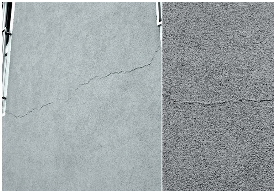
Typische Quetschfalten, z.B. weil die Dämmplatten nicht ausreichend oder ungeeignet verklebt sind.
