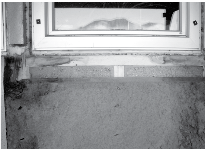
Erheblicher Schaden an WDVS und der Holzkonstruktion aufgrund undichter WDVS-Anschlüsse zum Fenster und zur Fensterbank; die dunklen Flecken zeigen die bereits zerstörte Holzfaserdämmplatte.
