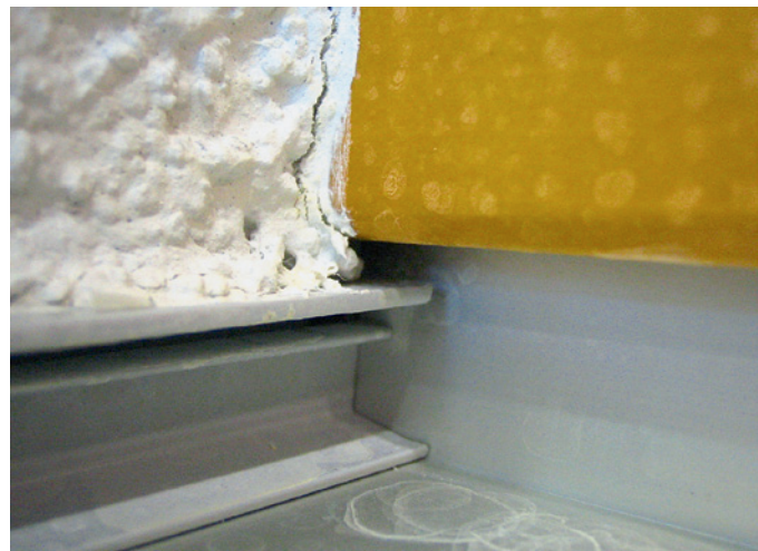
Über Gewerklöcher dringt Wasser ein, wie hier in der Ecke zwischen Fenster, Fensterbank und Fassade.
