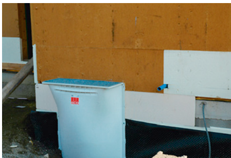
Bedenken anmelden: Das WDVS (Holzweichfaser und EPS) reicht bis unterhalb des Geländeniveaus (am bereits montierten Kellerlichtschacht erkennbar).
