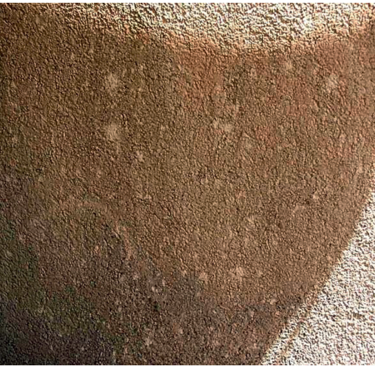
Bild 8: Durch Hagel entfernter Pilzbewuchs an einer Fassade.
