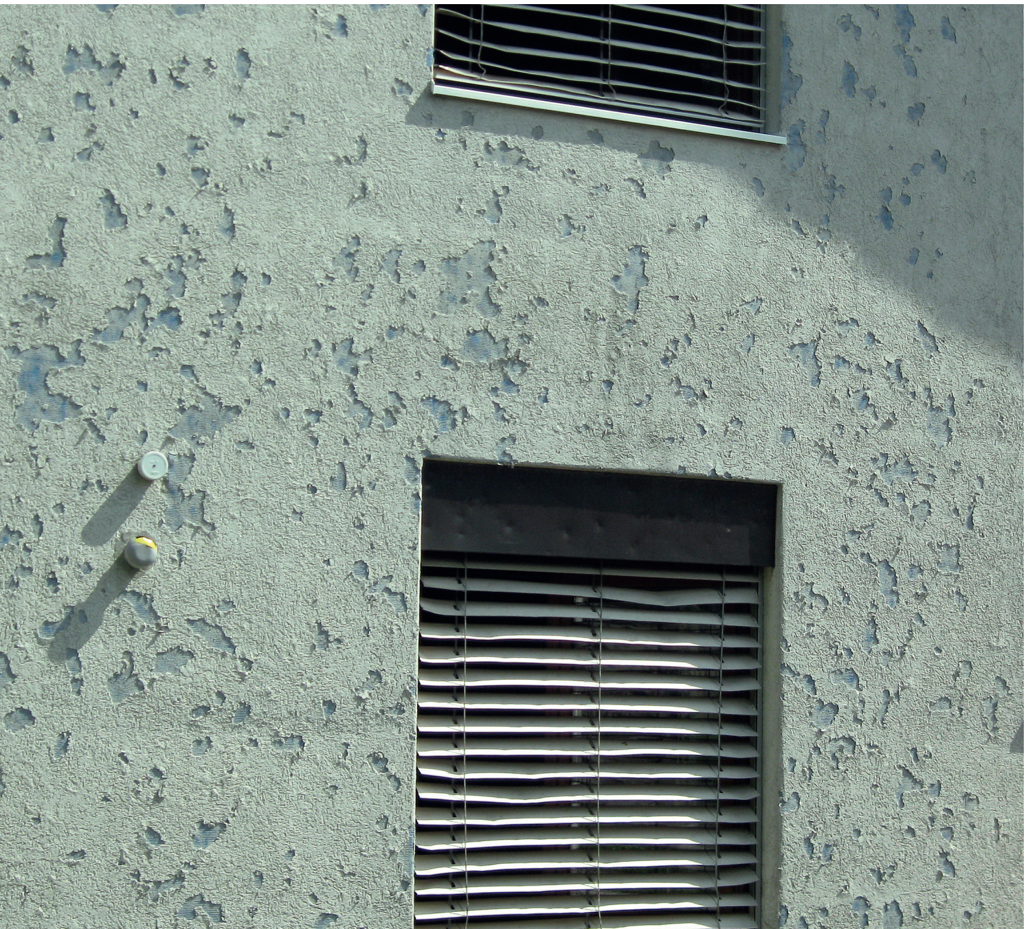
Bild 10: Fehlerhafte Appli- kation der Putzsichten?
